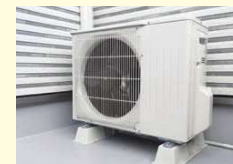
室外機とポンプ ※この画像はイメージです
